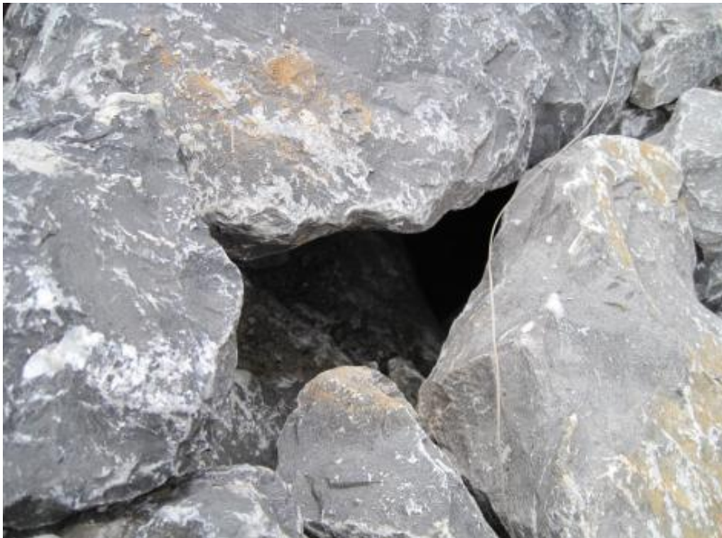
质量管理图 1-2 排水棱体干砌块石砌筑质量不符合要求，干砌块石架空
